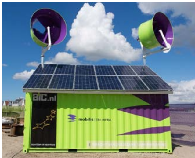
Afbeelding 6.3: mobiele batterij voor op de bouwplaats inclusief duurzame opwekking.
