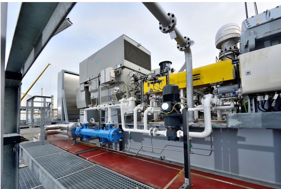
Stoomrecompressor Dow Terneuzen
