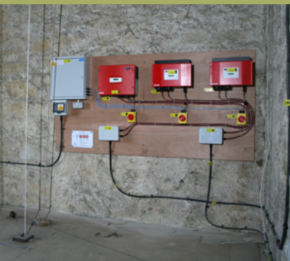
Bijbehorende apparatuur op een onderconstructie, zodat er minder boorgaten nodig zijn
