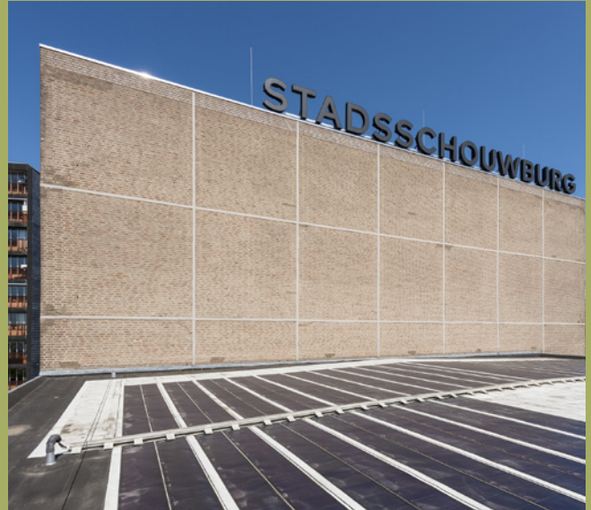
Pv-folie voor stroomopwekking op een plat dak
