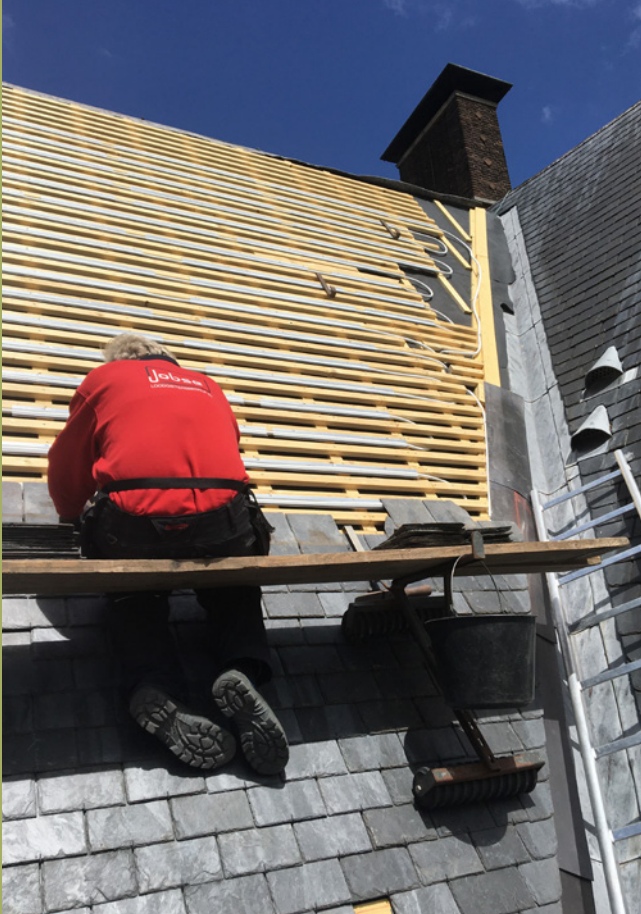
Zonthermisch dakstelsel om warmte te winnen voor onder dakpannen en – zoals hier – leien
