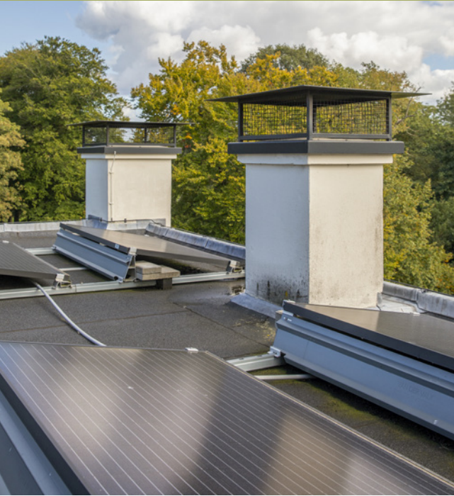
Zonnepanelen voor stroomopwekking
