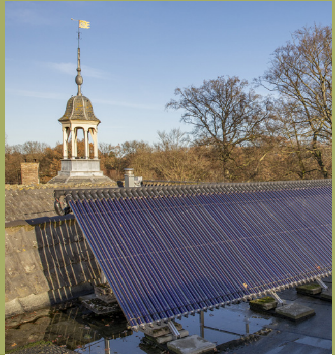
Vacuümbuiscollectoren voor warmtewinning
